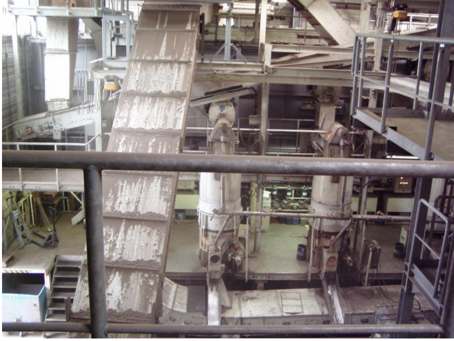
Katı atık arıtma sistemindeki mekanik ekipmanlar
