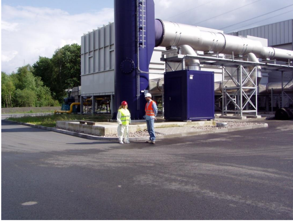
Elektrik üreten bir katı atık arıtma tesisinin dış donanımları
