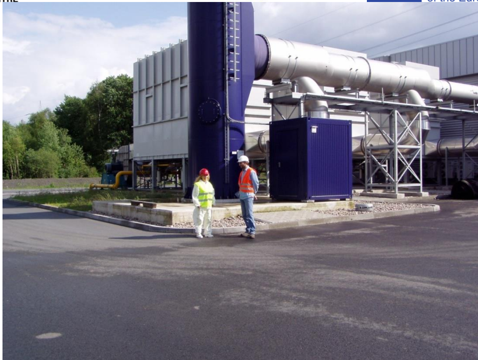
Außenausrüstung einer Festabfallbehandlungsanlage, die Strom erzeugt
