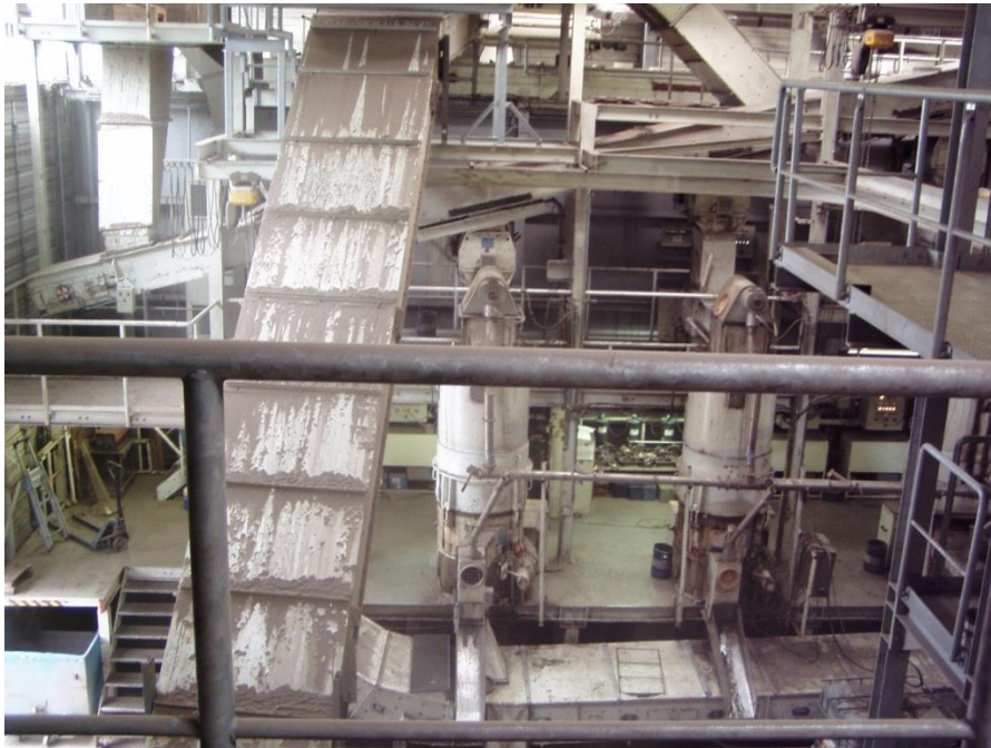
Mechanische Geräte in einem System für die Festabfallbehandlung
